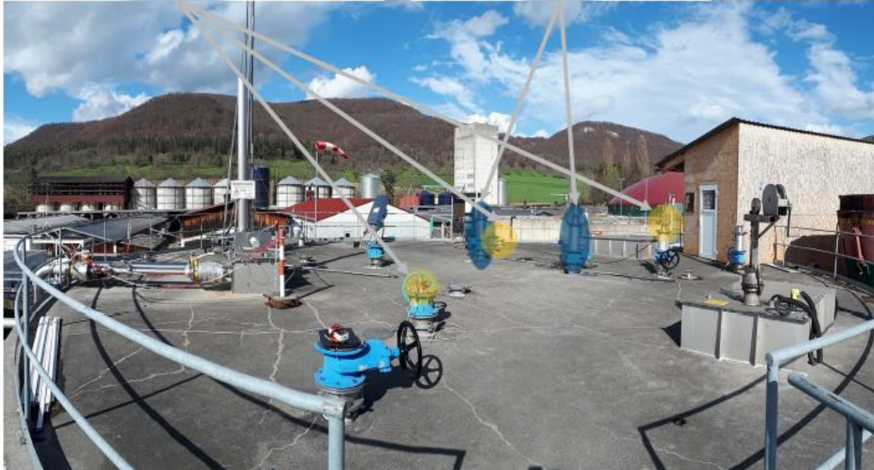
Sensorschleusen mit Prozesssensorik (© UHOH)
